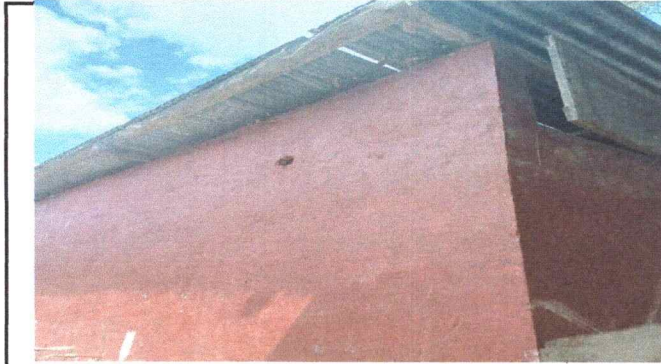
Foto1: Se observa el deterioro de la estructura del techo del tanque de agua.
