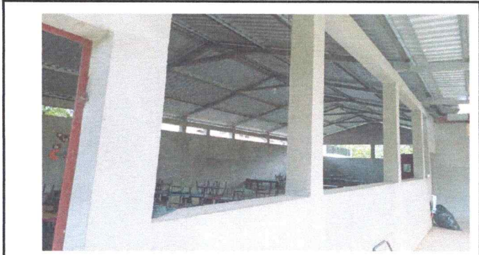
Foto1: Se observa la Falta de estructura metalica de ventanas de dos aulas. Modulo 1.
