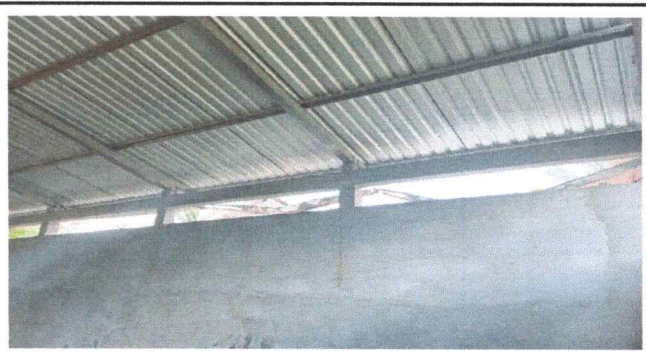
Foto 2: Se observa el deterioro de canales. Modulo 1.
