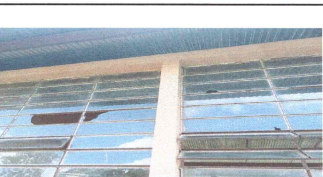
Foto 6: Se necesita sustitucion de vidrios de algunas ventanas. Modulo 2.
