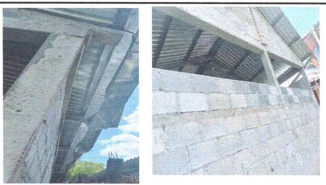
Foto 4: se necesita repello mas sernido en la parte de atrás de las dos aulas. Modulo 1.
