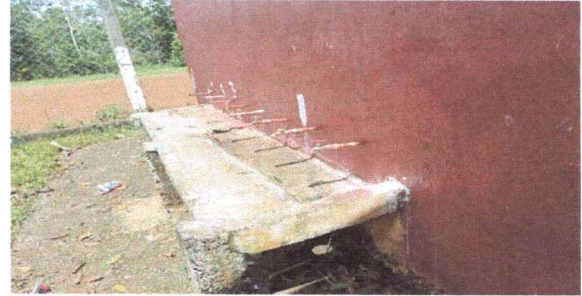
Foto 2: se necesita mantenimiento al modulo de chorros de lavamanos .
