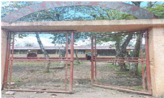
Foto3 : se observa el deterioro de tubos y malla del porton principal.
