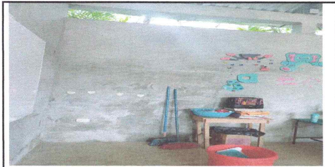
Foto 3: se observa la humedad de pared de este salon de clase. Modulo 1.
