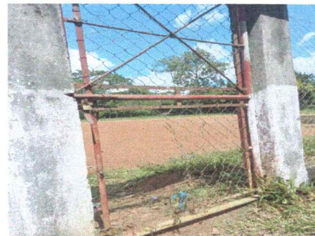
Foto 4: se observa el deterioro de la estructura metalica de la puerta para el acceso al campo de fut.
