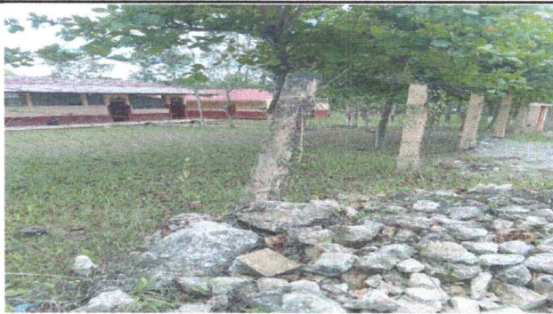
Foto 5: se observa deterioro del muro perimetral en la parte frontal.
